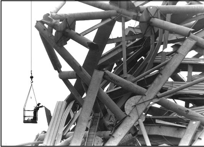
Рис. 29-1. Навес над футбольным стадионом Вашингтонского университета обрушился, не выдержав собственного веса во время строительства. Он скорее всего был бы достаточно прочным после завершения работ, но строительство велось в неправильном порядке — налицо ошибка интеграции
